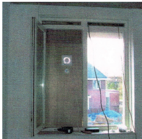
Figuur 2. Mechanische ventilatieafvoer met meetinstrument voor de luchttemperatuur en de relatieve luchtvochtigheid.
